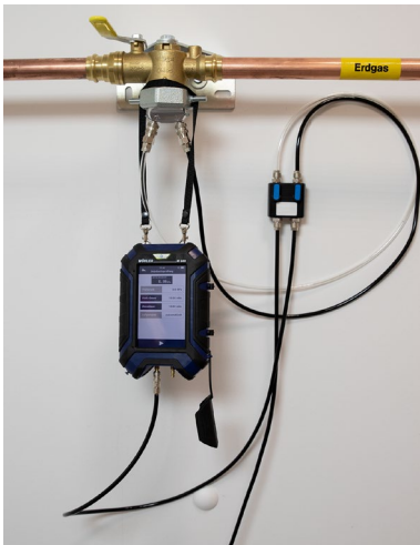
Abb. 25: Anschlüsse zur Dichtheitsprüfung
