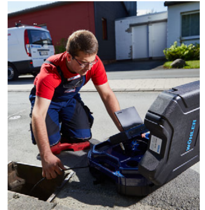
Der wasserdichte Kamerakopf ermöglicht unter anderem die Inspektion von Abwasserkanälen. Dabei sorgt der integrierte Blendschutz auch bei starker Sonneneinstrahlung für beste Sicht auf den Monitor.
